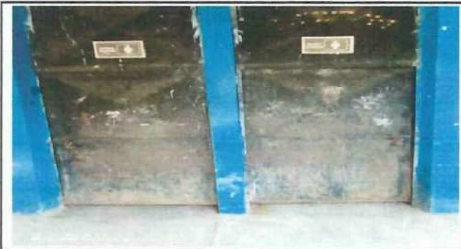
Foto 3: Puertas donde se puede observar que necesitan reparación y mantenimiento
