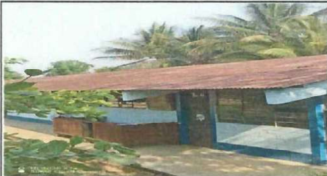
Foto 1: Techo de Módulo 1 donde se observa el deterioro de las láminas
