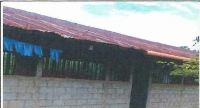
Foto 2: Techo de Módulo 2 donde también se observa el deterioro de las láminas
